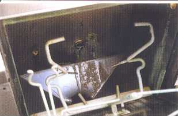
Problemzone: Keimnester in Spülkammerdichtungen gefährden Bediener und Patienten
